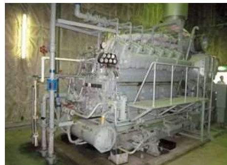
自家発電設備
