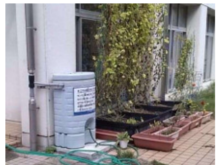
【学校に設置された雨水貯留タンク】
