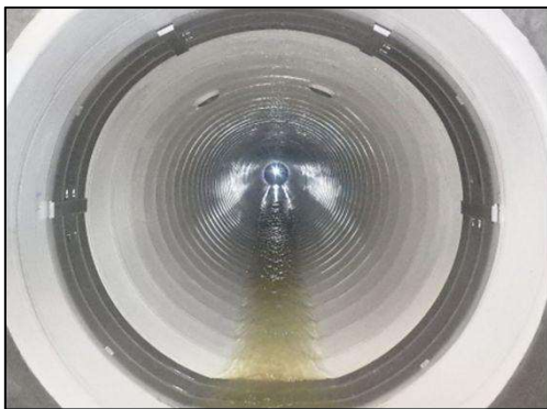
地震対策 管きよ耐震継手 [谷場幹線]
