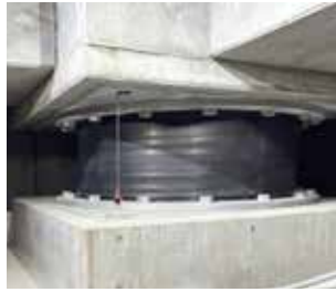
免震装置（千葉市役所） 出典：千葉市ホームページ
