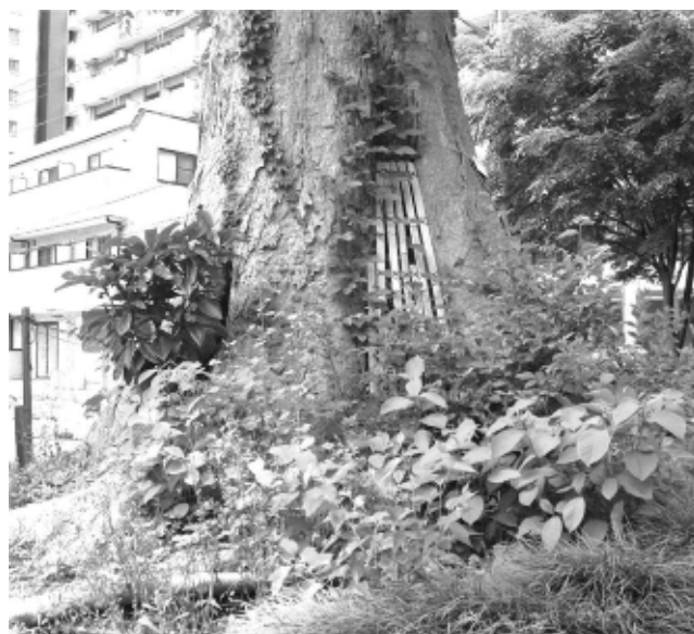
▲令和 2 年 5 月 25 日撮影 竹柵で塞がれた開口部
